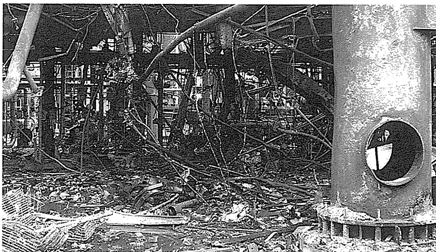
Nach der Explosion 2008
